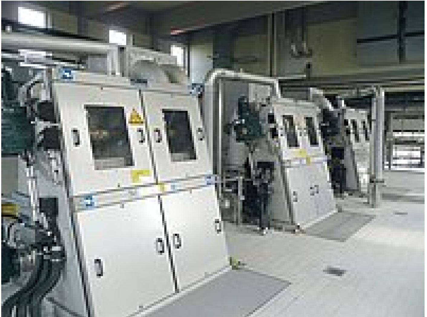
Three HUBER RakeMax® screens on WWTP Magdeburg/Gerwisch
