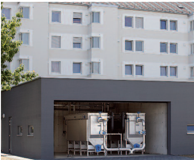
Värmestation med HUBER RoWin värmeväxlare
