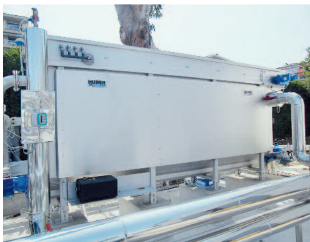
Uttag av kyla på 120 kW, använt för kylning av en lagerbyggnad
