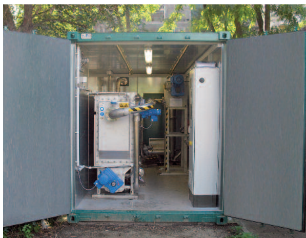
Exempel på containerlösning med uttag av värme på 60 kW, använt för uppvärmning av en sportanläggning och en förskola
