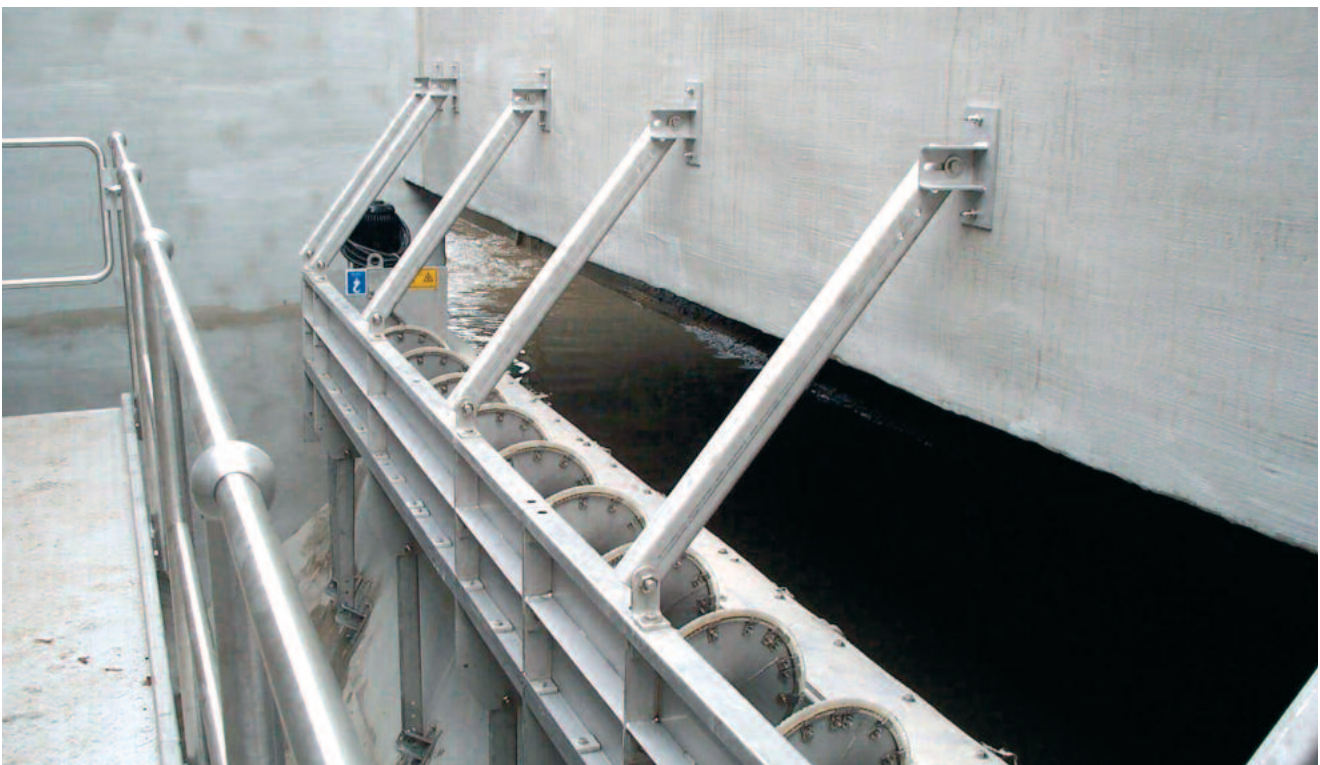
HUBER Siebanlage ROTAMAT® RoK1 an einem Regenüberlaufbecken.
