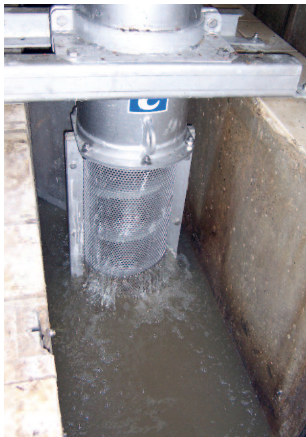
HUBER Schachtsiebanlage ROTAMAT® RoK4 im Zulaufgerinne einer Kläranlage im Betrieb.
