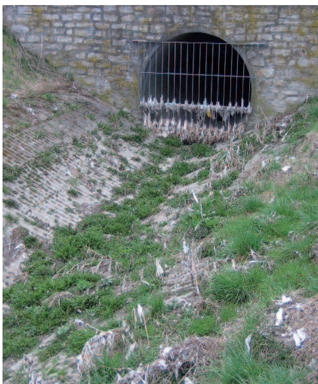
... Regenauslassbauwerk ohne vorgeschalteten Feinsiebrechen.
