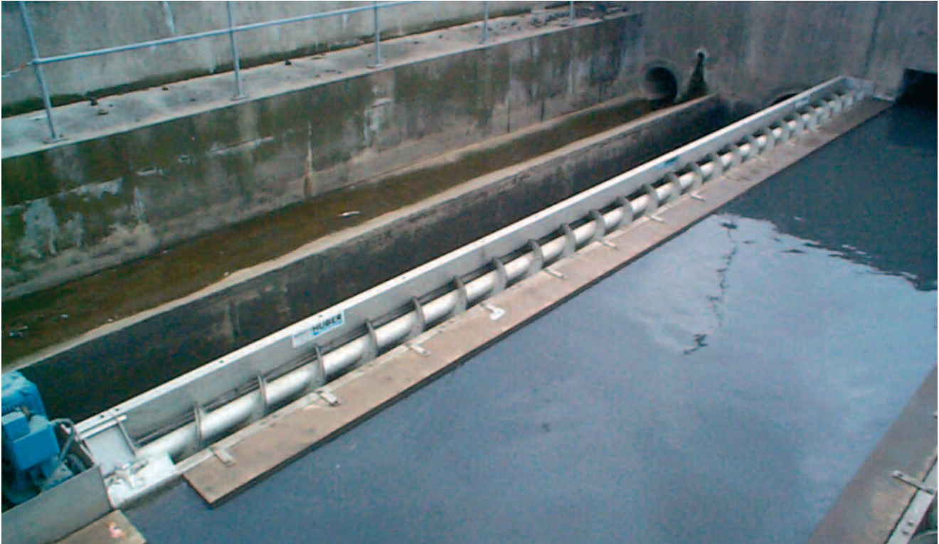
HUBER Siebanlage ROTAMAT® RoK1: Siebung der Entlastungswassermenge nach der Entlastungsschwelle
