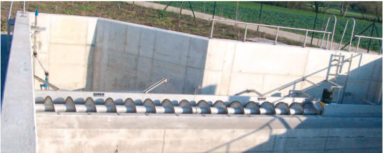
HUBER Siebanlage ROTAMAT® RoK1 als Überlaufsiebung am Kläranlagen Zulauf.
